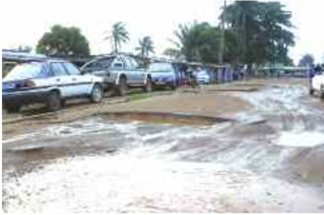
Au niveau du Château en allant vers le Moyo, des trous immenses rendent la chaussée impraticable.
