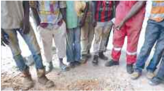
Des ouvriers sans équipement de sécurité sur le chantier du nouveau stade.
